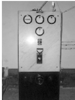
Cuadro de control
