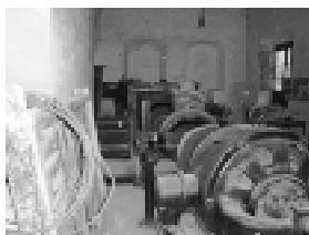
Sala de máquinas
