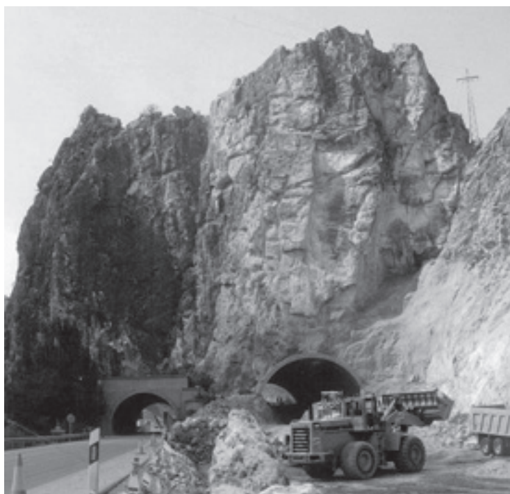
Destrucción sufrida por el asentamiento con la apertura del tercer túnel.
