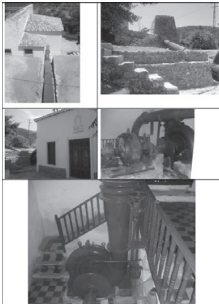
Figura 15: Situación actual de las instalaciones. 2014
